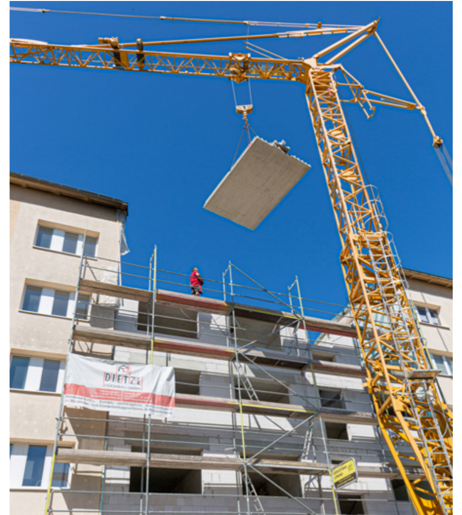
Nach einer Explosion muss der Barclayweg 16 in Leipzig-Meusdorf neu errichtet werden.
