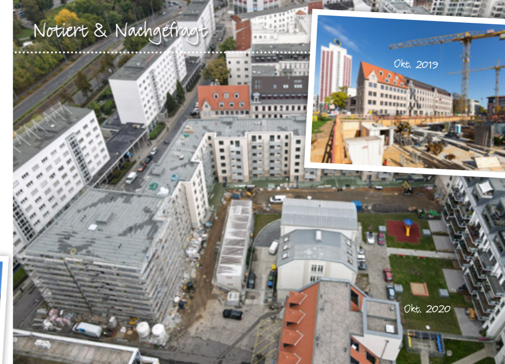
Die Littstraße 2-8 aus der Vogelperspektive im Herbst 2020 (gr. Foto). Die Fertigstellung ist zum Greifen nah. Mitte Oktober 2019 wurde noch an der Bodenplatte gearbeitet.
