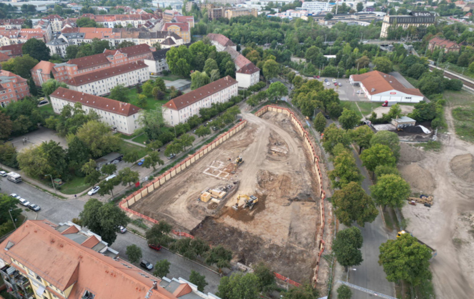
In der Gaußstraße haben im Sommer 2022 die Bauarbeiten begonnen. Hier werden 123 neue LWB Wohnungen errichtet.
