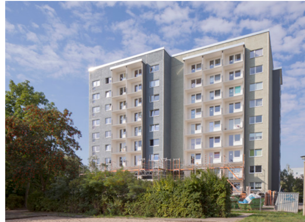
Die LWB saniert derzeit Wohnhäuser in verschiedenen Stadtteilen, so beispielsweise in der Jupiterstraße in Grünau.
