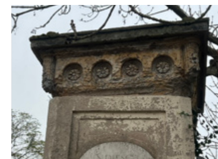
Säulenschmuck an der Einfahrt: Die verzierten Portale werden denkmalgerecht saniert. Geplant ist zudem, die steinernen Löwen, die auf den Säulen thronen, wieder auferstehen zu lassen.
