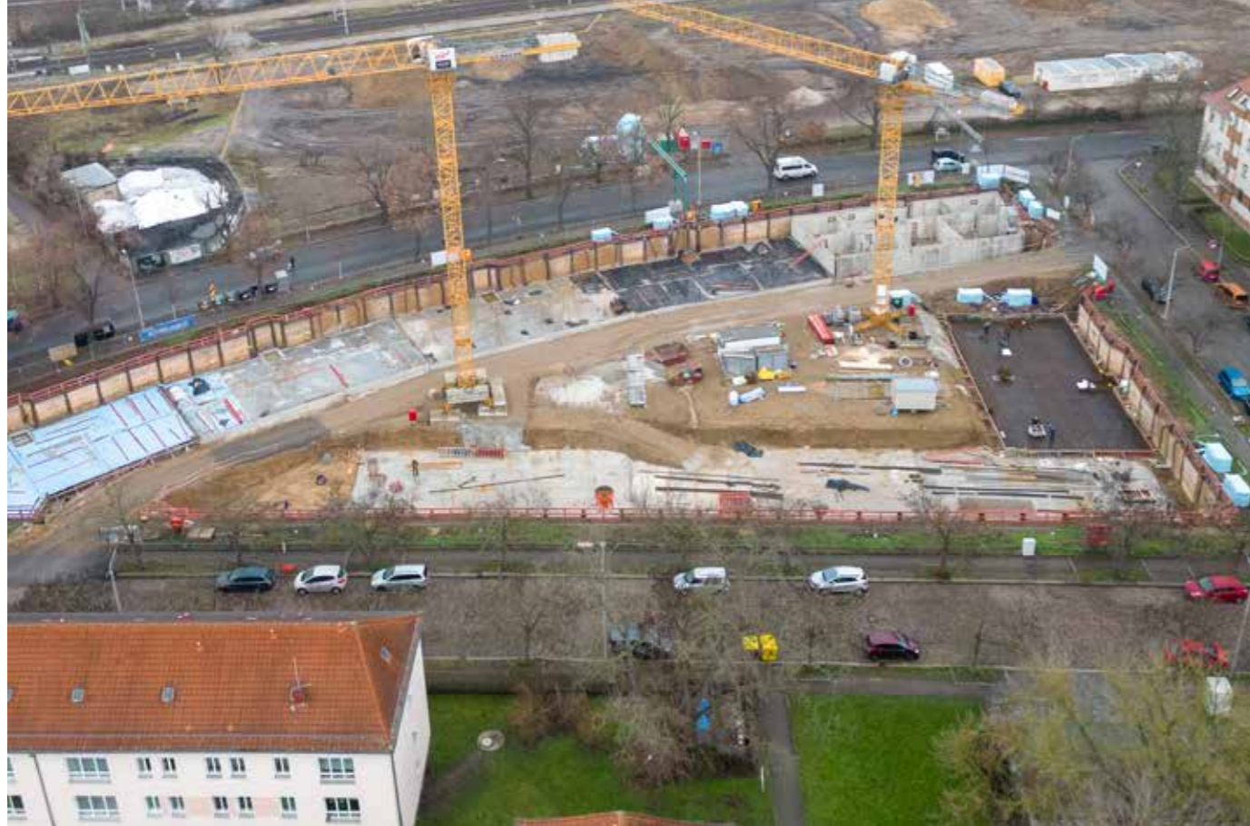
Blick auf die Baustelle in der Gaußstraße Ende 2022: Hier entstehen bis 2024 insgesamt 123 geförderte Wohnungen.
